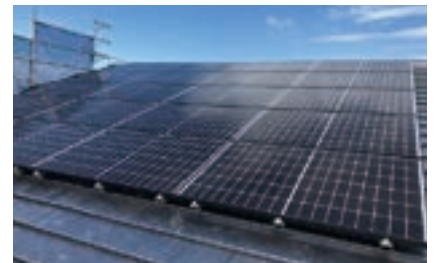
太陽光パネル
